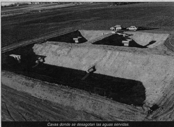
Cavas donde se desagotan las aguas servidas.
