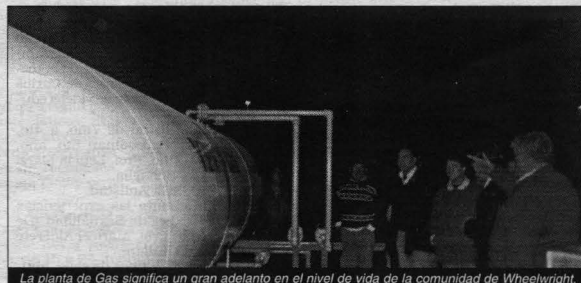
La planta de Gas significa un gran adelanto en el nivel de vida de la comunidad de Wheelwright.
