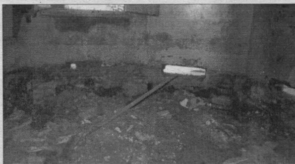
Una de las habitaciones a las que se le habían levantado los pisos. Ahora la obra está detenida.
