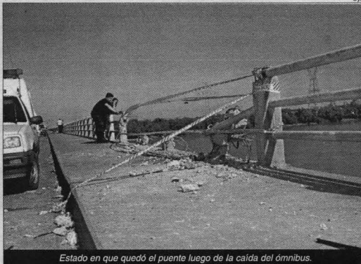
Estado en que quedó el puente luego de la caída del ómnibus.
