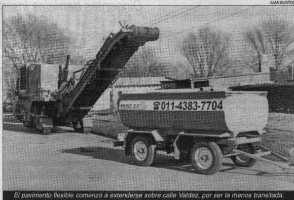
El pavimento flexible comenzó a extenderse sobre calle Valdez, por ser la menos transitada.
